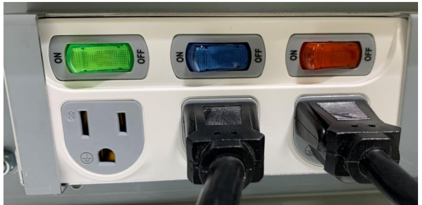
图 3 - 3: 流水线马达电源、电控箱电源
